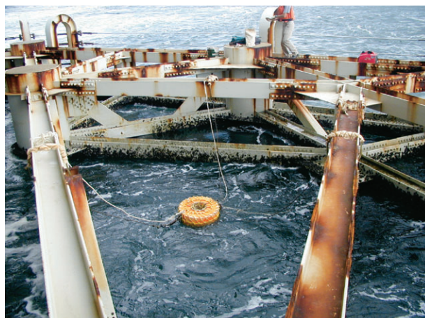
写真1 流速計設置写真 Photo.1 current meter installation
