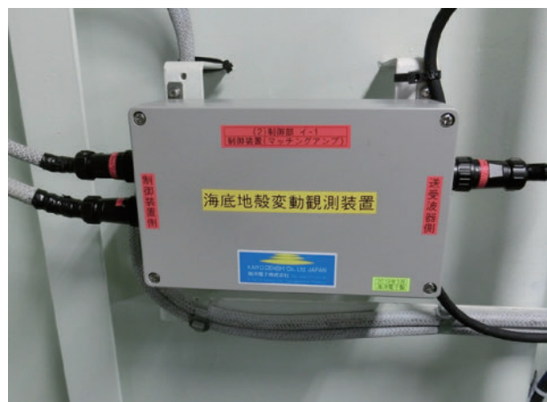
Photo 4. Matching amplifier. 写真4. 「平洋」中央重力計室に設置したマッチングアンプ.
