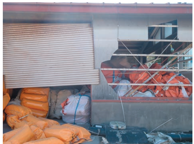
写真 16 g 崩れた保管庫. Photo 16 g Destroyed storage.
