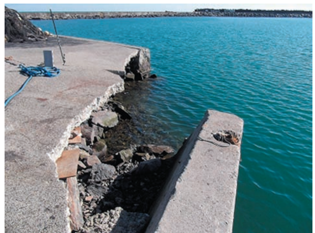
写真 21 a 崩れた護岸 (会瀬港). Photo 21 a Destroyed seawall (Ose Harbor).
