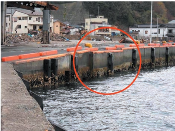
写真 2 e ずれた岸壁。 Photo 2 e Shifted quay.
