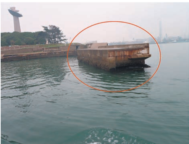
写真 16 e 崩れた栈橋. Photo 16 e Destroyed pier.
