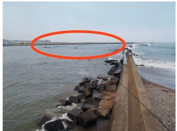
写真 20 沈下した防波堤. Photo 20 Breakwater which subsided.
