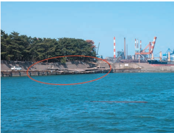
写真 16 d 崩れた岸壁. Photo 16 d Destroyed quay.
