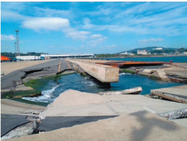
写真 11 b 崩れたふ頭。 Photo 11 b Destroyed wharf.
