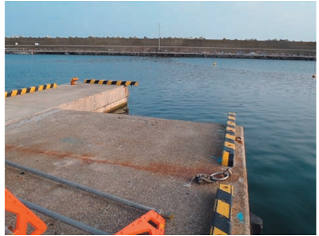
写真 15 a 崩れた岸壁。 Photo 15 a Destroyed quay.
