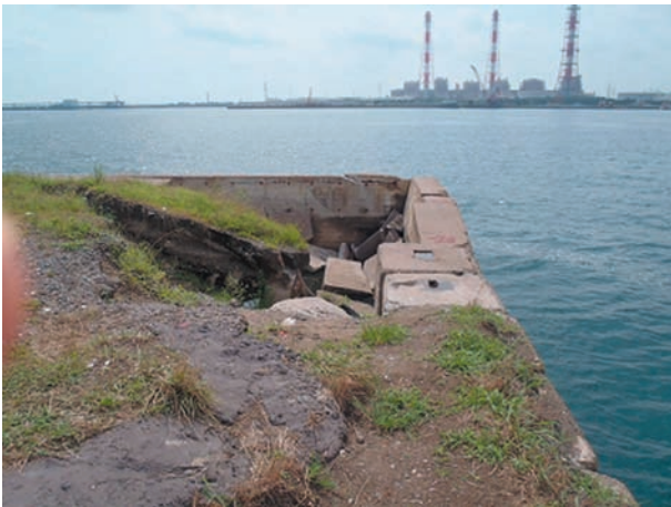
写真 17 b 崩れた護岸。 Photo 17 b Destroyed seawall.
