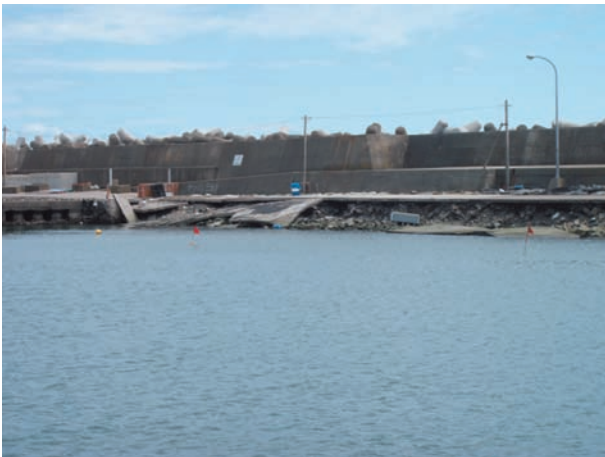
写真 14 e 崩れた岸壁。 Photo 14 e Destroyed quay.
