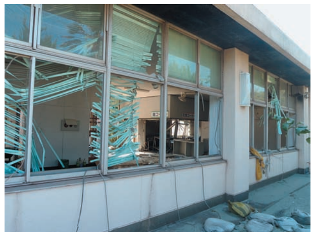
写真 16 h 崩れた待合所. Photo 16 h Destroyed lounge.
