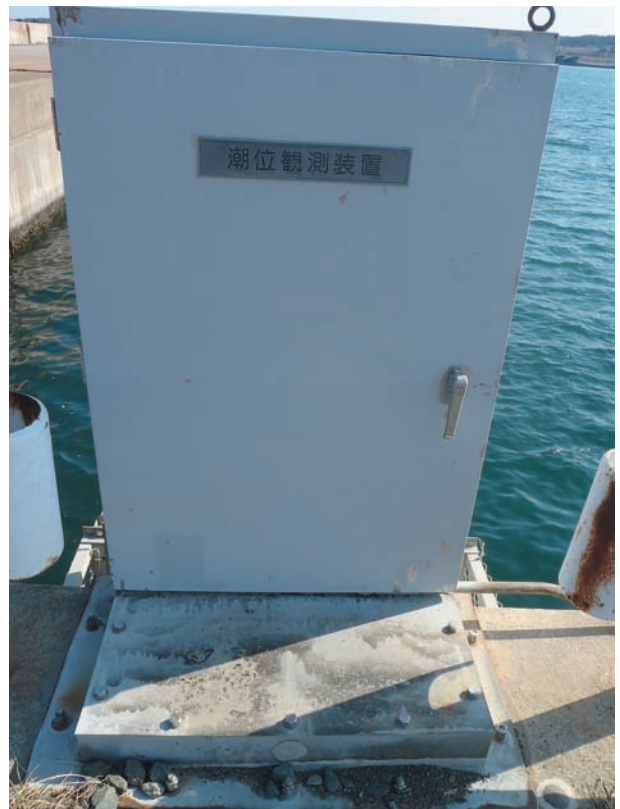
写真 12 a 常陸那珂港験潮所。 Photo 12 a Hitachinaka-ko tidal station.
